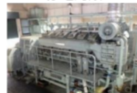
例：自家発電機の整備
