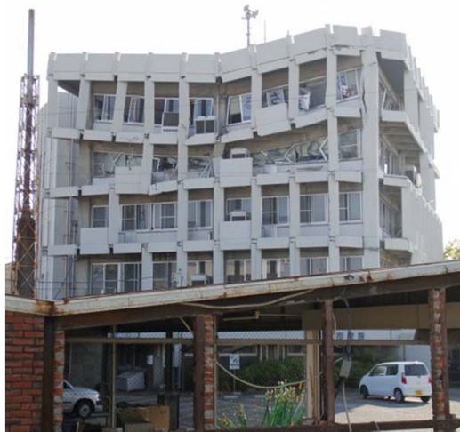
熊本地震で被災した宇土市役所 (出所) 宇土市役所ホームページ
