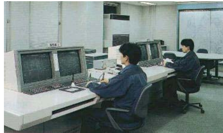
制御所(配電系統制御)
